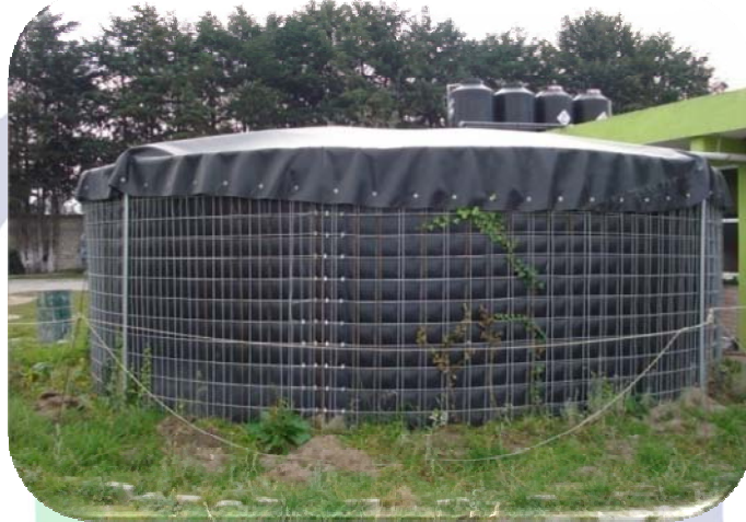
Depósito de Agua a Base de Geomembrana
